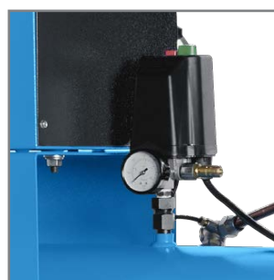
Automatické řízení chodu tlakovým spínačem.
